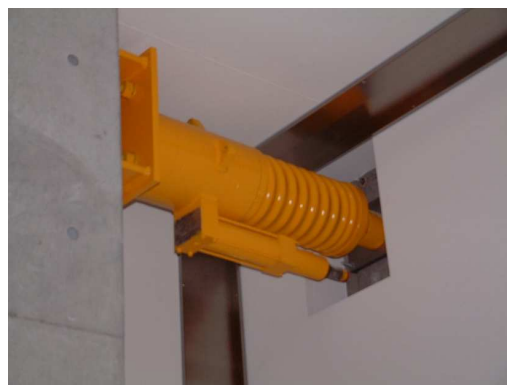
設置された圧縮型減衰装置位置 (撮影: 西村研究室)
